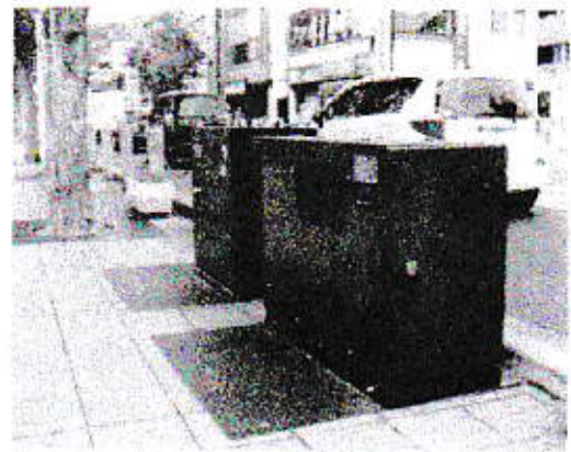
歩道の変圧器、遮断機
